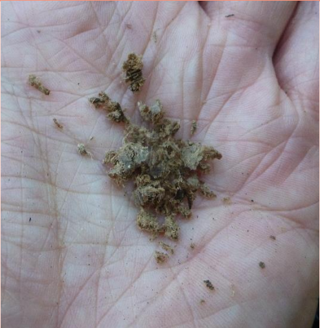
Figur 19: Borspon, fuktig og kraftig angrepet av råte.
