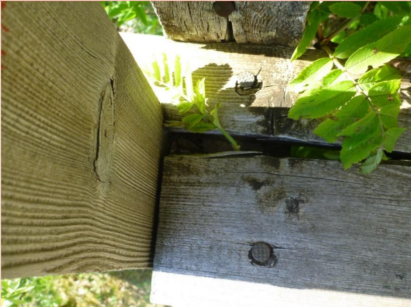
Figur 27: Rotasjon at søyle har medført skader på trinn. Bilde fra nær akse 3-22.
