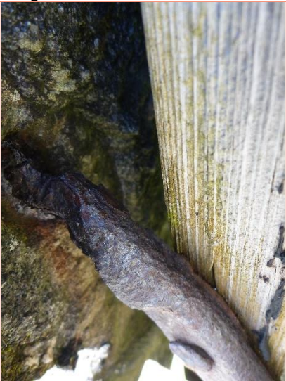
Figur 28: Kraftig korrodert bolt i øver del av seksjon 4.
