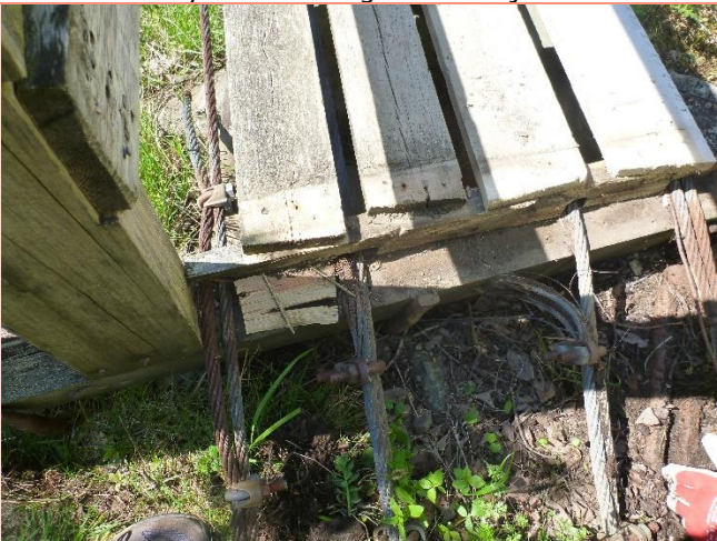
Figur 4: Sårbart punkt der bærekabler går over "sadelen".
