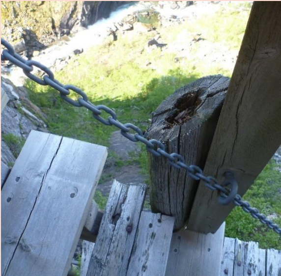
Figur 17: Topp søyle akse 2-5. Råte fra toppen.
