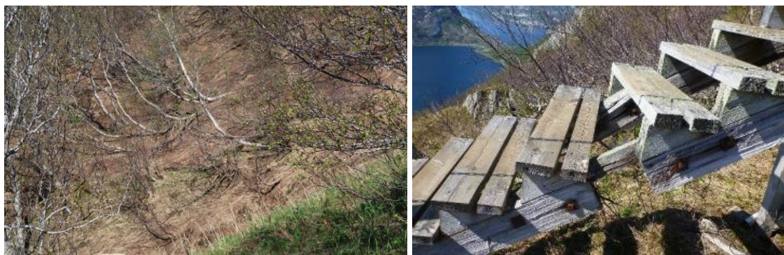
Bilde 1 og 2: Eksempel på effekten av snøsig mot vegetasjonen og trapp (bildet til høyre tatt mot vest i øvre tredjedel av seksjon 5) samt brudd i trappevangen omtrent i samme område som følge av effekten av snøsig på trappa (bildet til venstre tatt av COWI AS)
