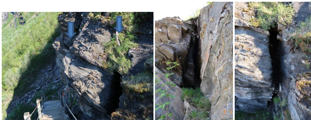
Bilde 5, 6 og 7 Baksprekker bak de avløste fjellpartiene i bilde 3 og 4. Bilde 5 (tv) viser de 2 baksprekkene (markert med piler). Bildet i midten (bilde 6) viser ytre (vestre) sprekk og bilde 7 viser indre (østre) sprekk.
