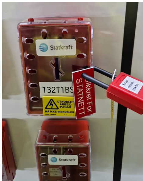
LOTO-boks sikring etablert for annet selskap
