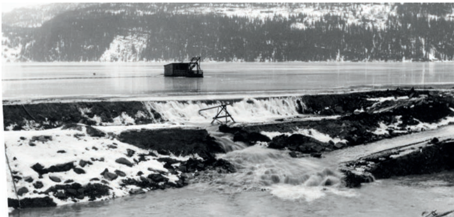
Flomvannet holdt på å bryte seg vei inn over fangdammen og inn i den halvferdige tunnelen da Langvatnet steg kraftig. Foto: Lind
