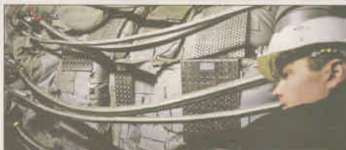
GLØHETE: Når denne enorme gasskraften starter om noen måneder, vil den produsere strøm på 1400 grader, bekrefter Statkrafts Torstein Skjott.
