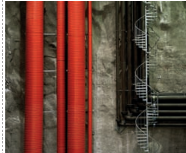
EN AV MASKINALENE PÅ AURA KRAFTVERK.
