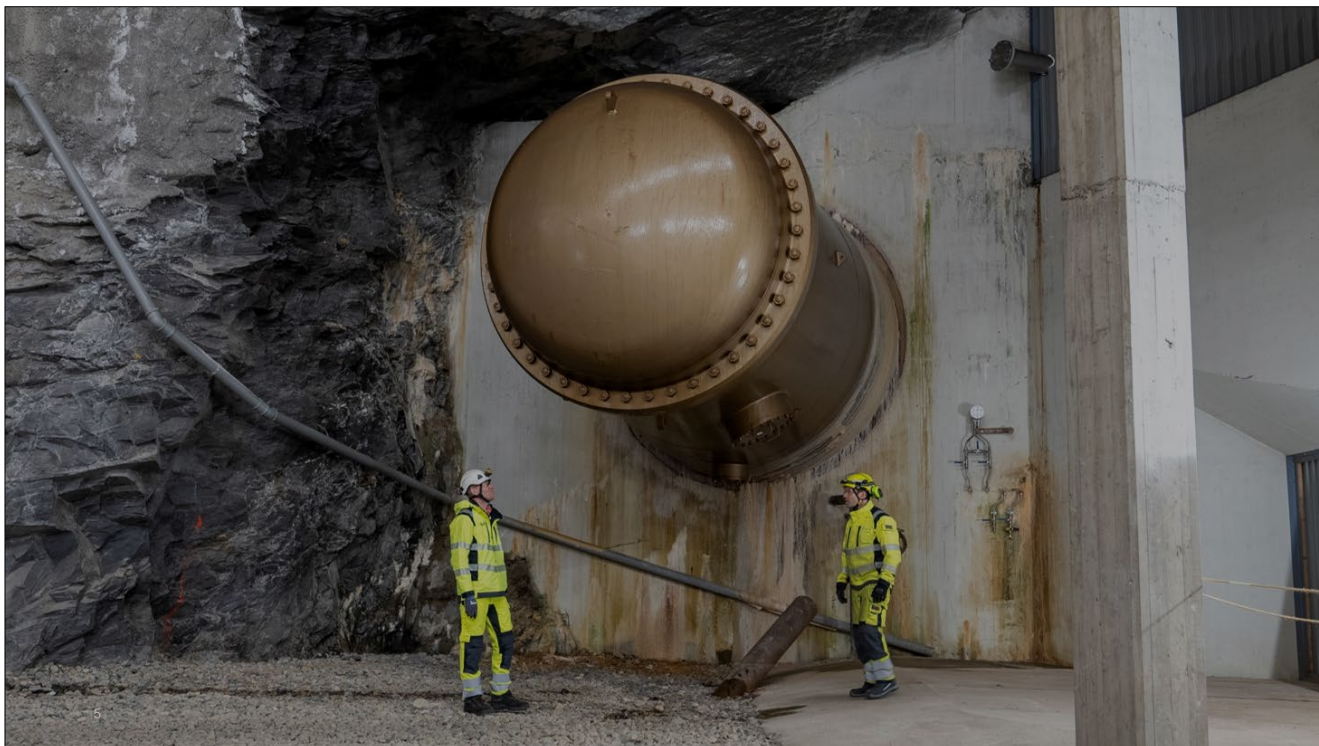
Figur 2. Vannrør fra tilløpstunnelen til et tredje aggregat (A3) allerede klargjort fra opprinnelig utbygging. Foto: Statkraft.
